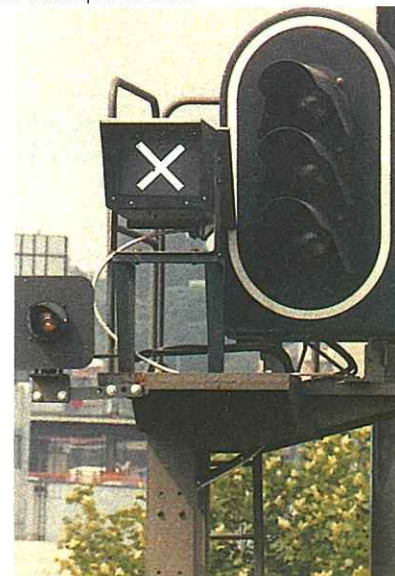
A l'approche des trains, SACEM éteint la signalisation latérale classique (l'apparition d'une croix blanche marque cette extinction).
