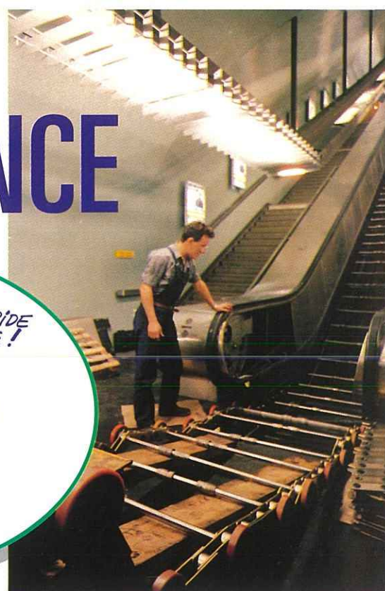
Audit de procédure : maintenance des escaliers mécaniques.
