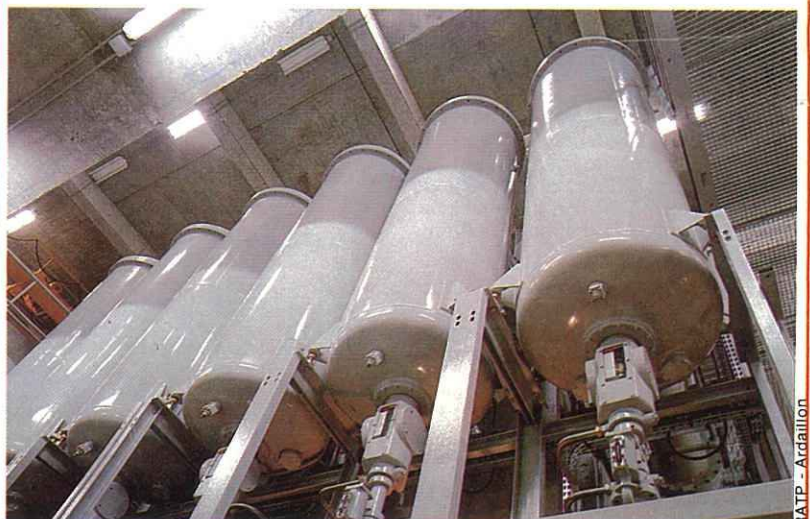
Batterie des caissons constituant les deux disjoncteurs 225 kV.
