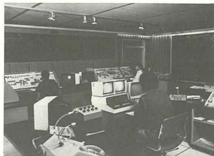
Poste d'aiguillage et de régulation
