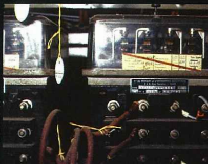
3 - De gros relais électriques, regroupés dans une salle spéciale, commandaient ensuite la mise en marche des moteurs d'aiguilles.
