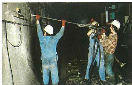
Perforation dans la maçonnerie.
