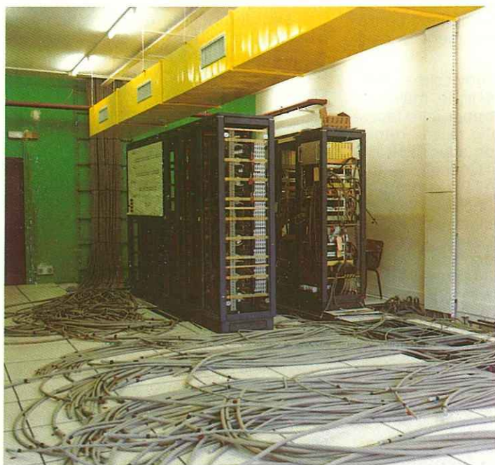
Vingt kilomètres de câbles relient les calculateurs à la salle de commande du PCC de Denfert.
