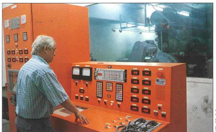
Salle d'exploitation et de commande contrôle du groupe électrogène diesel du PHT Denfert.
