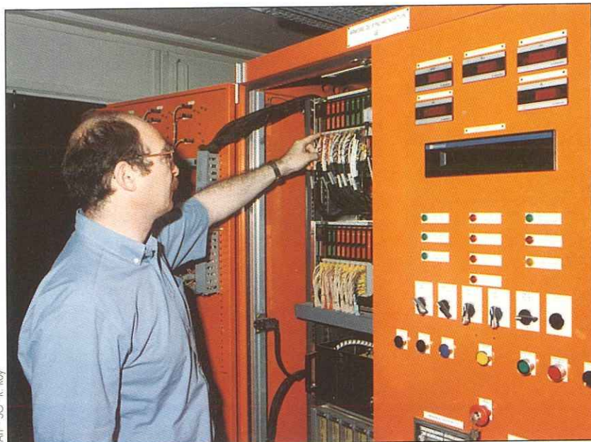
Surveillance de l'automate de contrôle-commande du groupe à turbine à gaz du PHT Montessuy.
