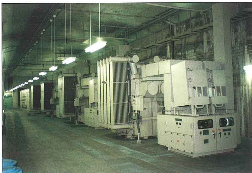
③ Osaka - Sous-station Kyobashi implantée sous la station. 3 groupes de 2 000 kW plus un transformateur. Au 1 er plan, groupe redresseur 2 000 kW refroidi au fréon et son transformateur de puissance.
