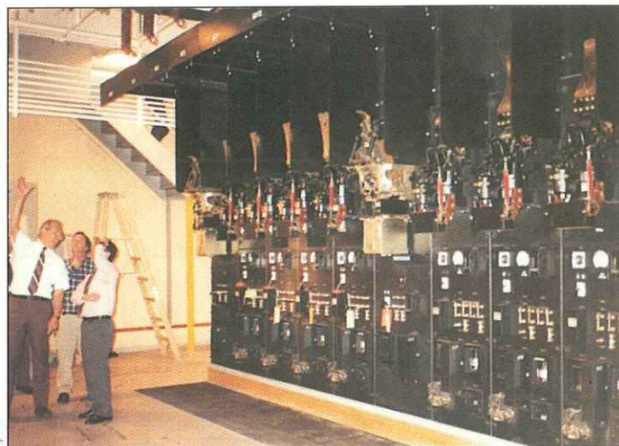
③ New York - Sous-station de redressement (53 e Street - 18 e Avenue) - Tableau des disjoncteurs tractions : deux disjoncteurs de groupe 10 000 A, un disjoncteur de sectionnement 10 000 A, huit disjoncteurs départ traction 4 000 A.
