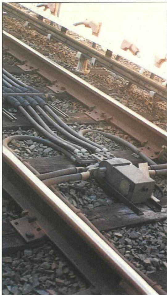
⑩ Washington - Détail du raccordement à la voie du retour d'une sous-station avec circuit de voie sans joint à fréquence acoustique.
