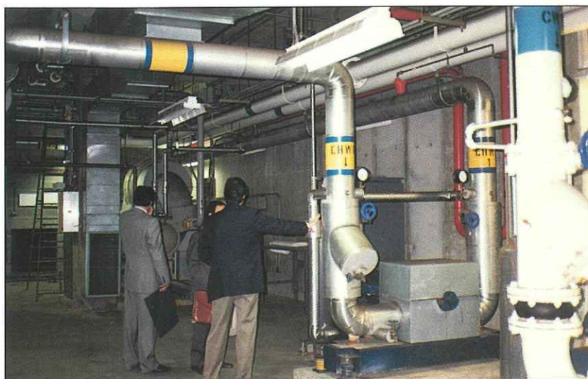
⑦ Washington, station Anacostia - Local de climatisation ( 600 \text{ kVA} ).
