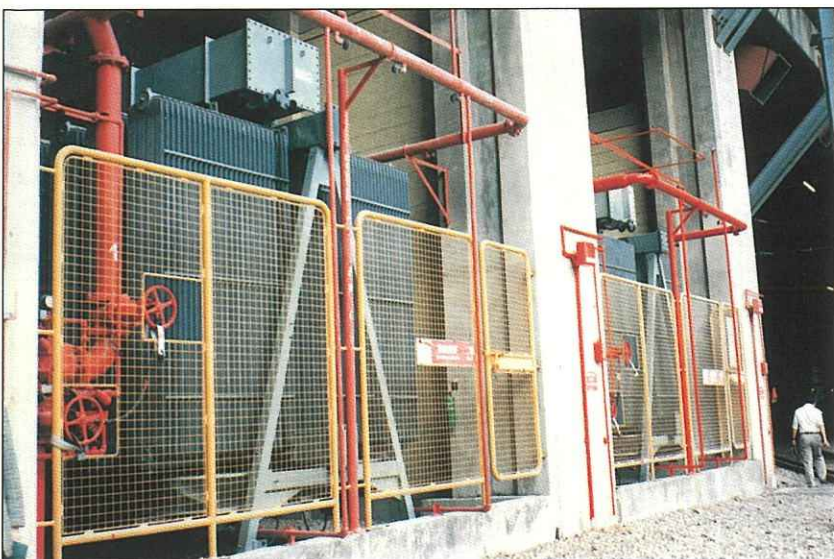
40 Hong Kong - Sous-station Kowloon Bay. Transformateurs extérieurs 132/33 kV - 50 MVA. Refroidissement à l'huile.
