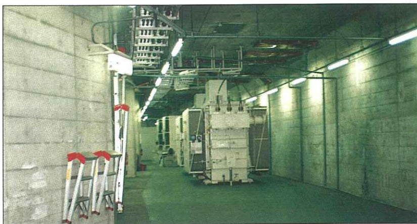
16 Tokyo - Sous-station Mitsuko Shimae (1988) - Vue générale de la sous-station souterraine (= 1 000 m 2 ). Au fond, les transformateurs pour l'élaboration du 1500 V et pour l'alimentation éclairage force.
