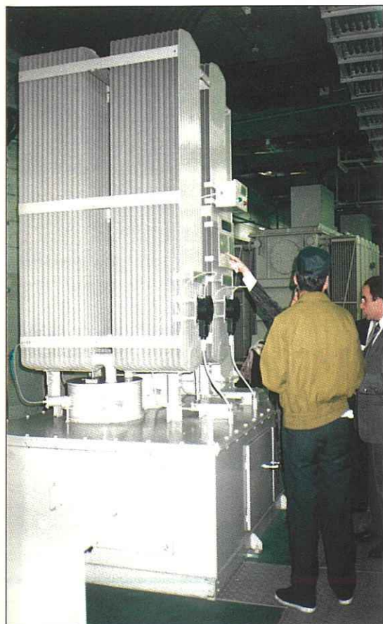
17 Tokyo - Sous-station Mitsuko Shimae. Groupe redresseur de 3 000 kW - 1 500 volts refroidi au fréon.
