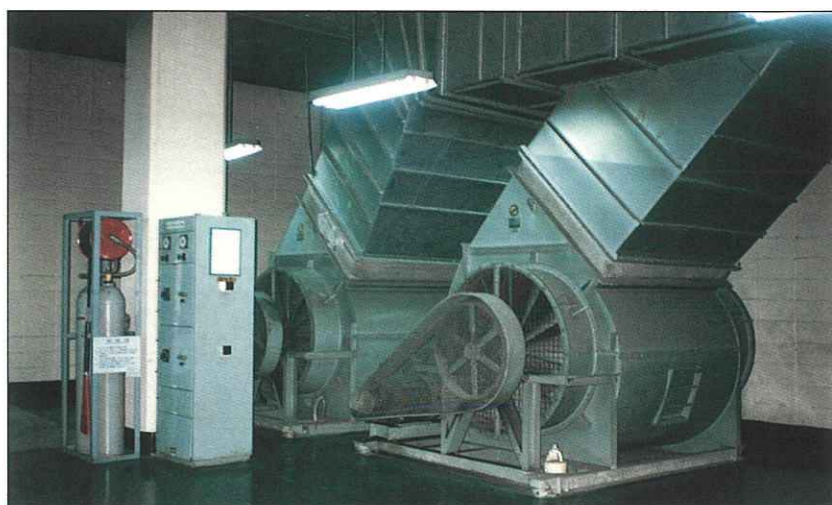
③⑦ Séoul - Ventilateurs de la sous-station Chong Shin College.
