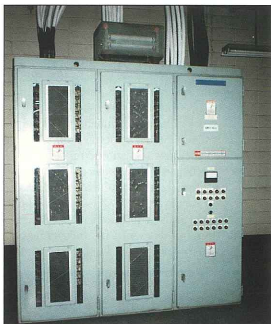
③⑤ Séoul - Sous-station Chong Shin College. Redresseur 4 000 kW Westinghouse à refroidissement naturel.
