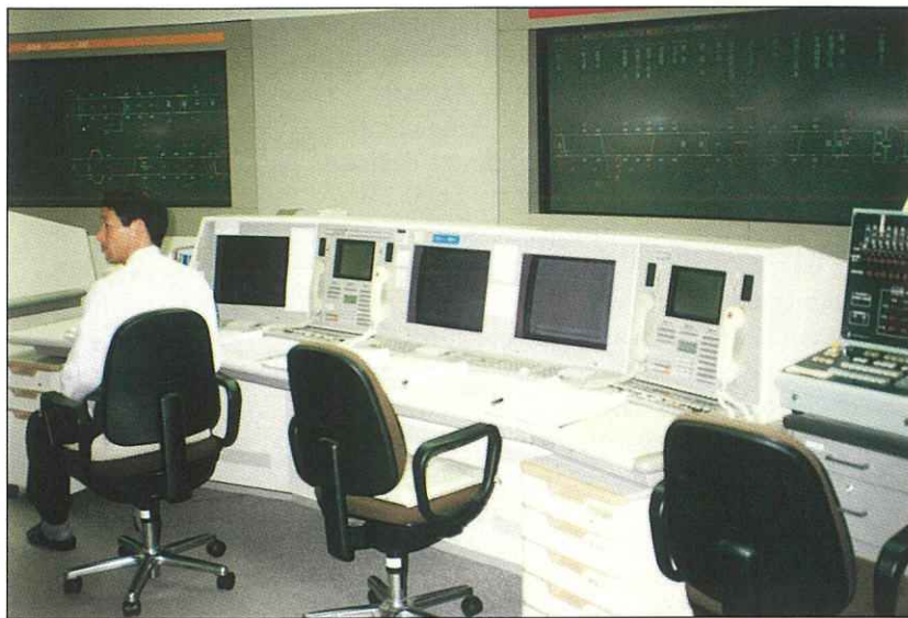
②① Tokyo - Centre de supervision du trafic et de l'énergie implanté aux ateliers de Koishikawa. Poste de travail de l'agent de régulation de la ligne Marunouchi. Suivi en temps réel des trains sur écrans avec rétroprojection.
