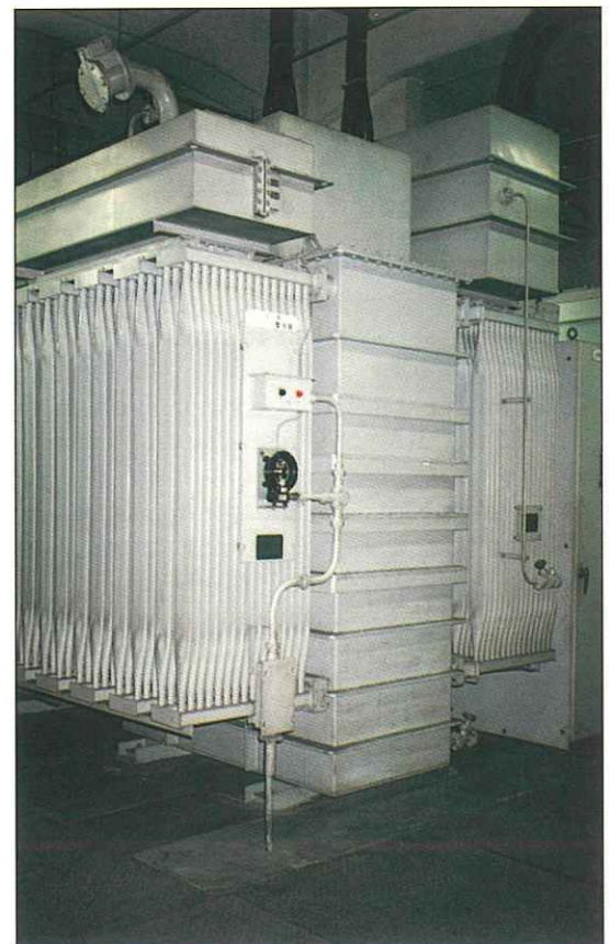
28 Nagoya - Transformateur et bloc redresseur refroidis à l'huile.
