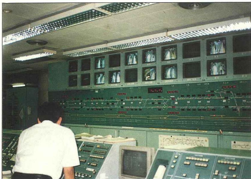
② bis - Nagoya - Poste de commande centralisé. Tableau de contrôle optique du trafic ligne 6 (1 500 V) avec écrans de surveillance.
