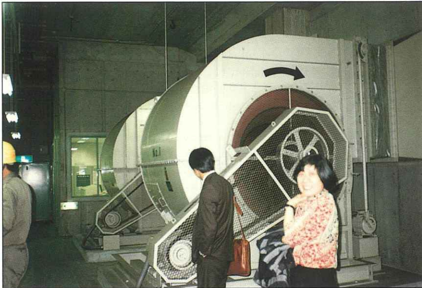
❶ Osaka - Ventilateurs de la sous-station Kyobashi - 1 500 m 3 /mm 18 kW x 2.
