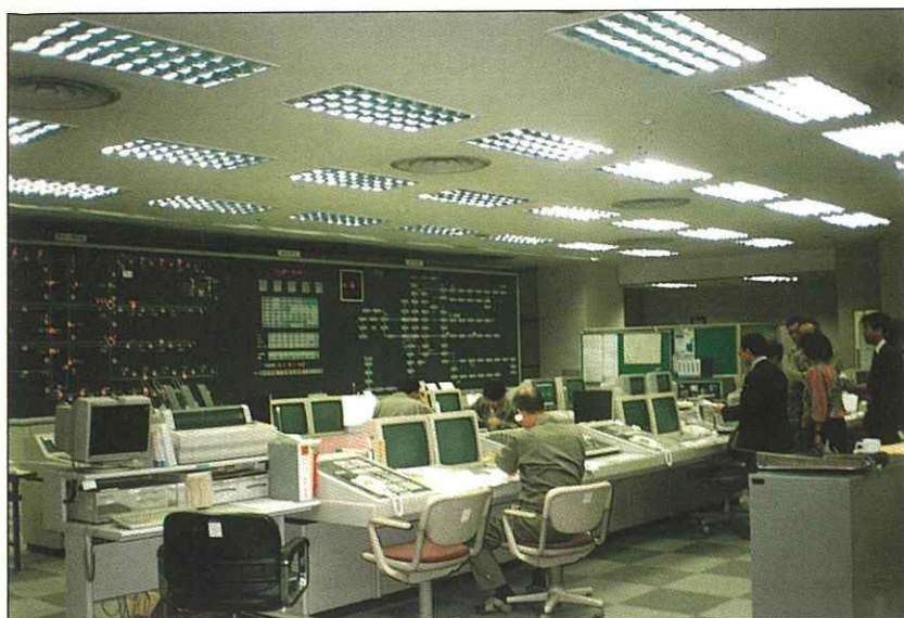
② Osaka - Poste de commande de l'énergie électrique. Partie droite du TCO. Visualisation des alarmes des stations : ventilation, incendie, PEF.
