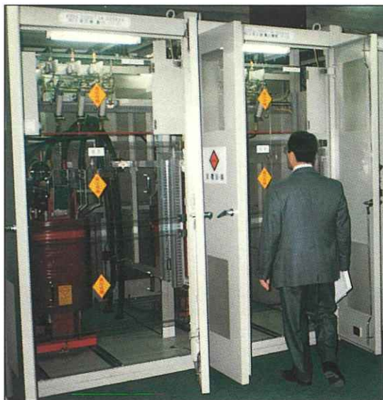
②① Tokyo - Sous-station Mitsuko Shima. Une tranche de transformateurs 2 x 300 kVA ; au premier plan, transformateurs secs.
