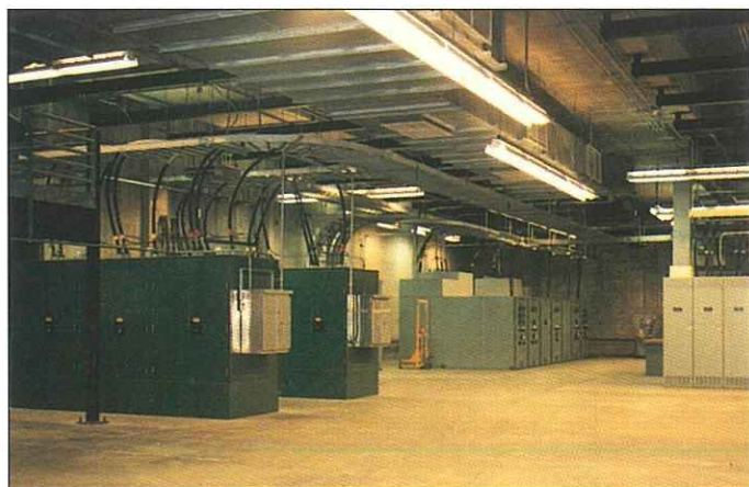
⑧ Washington - Sous-station Van Dorn Street. Puissance 2 \times 2\,000 \text{ kW} ( 750 \text{ V} ). Disposition des équipements : arrivées triphasées 34,5 \text{ kV} , disjoncteurs AC Siemens à coupure dans le vide, départs traction 750 \text{ V} .
