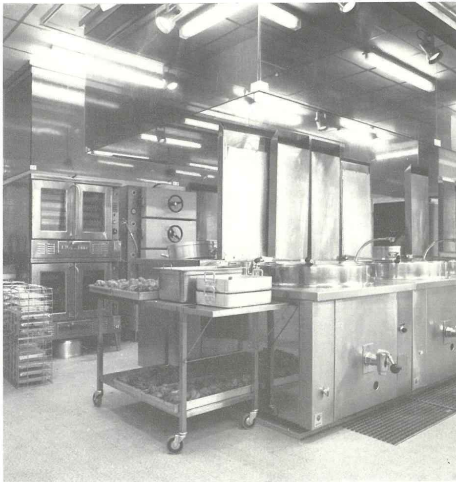
Dépôt de Créteil : vue générale de la cuisine centrale.
