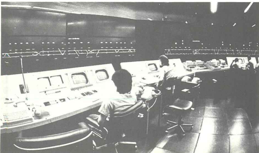
Poste de commande centralisée d'exploitation.
