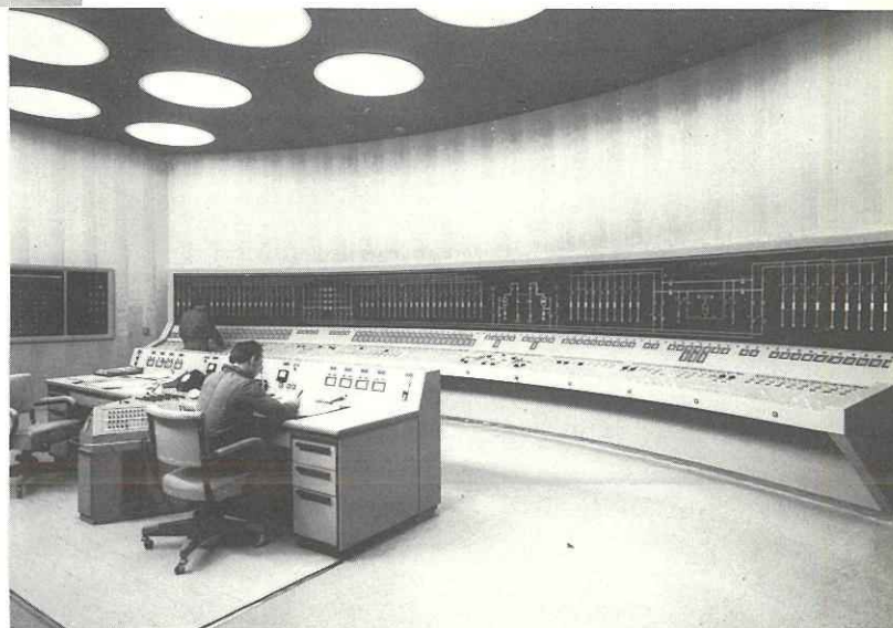
Fig. 48. — Poste 63 kV de transformation et de commande : salle de commande.
