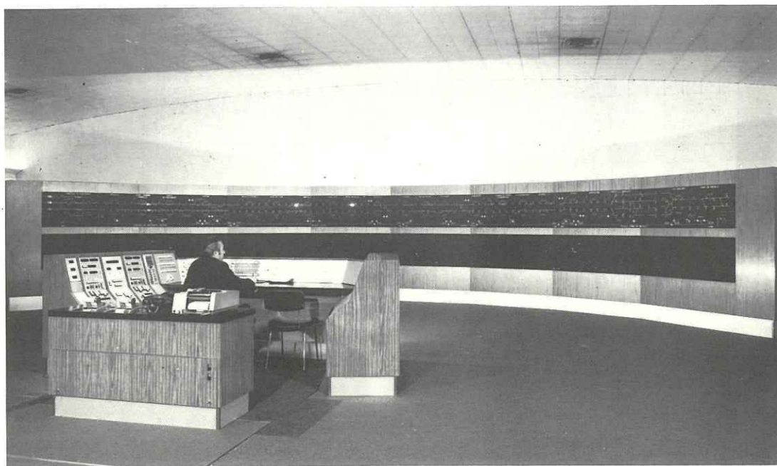
Fig. 45. — Poste de contrôle et de commande centralisés (ligne n° 1).
