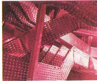
Chemin de câbles électriques dans la station « Gare de Lyon ».
