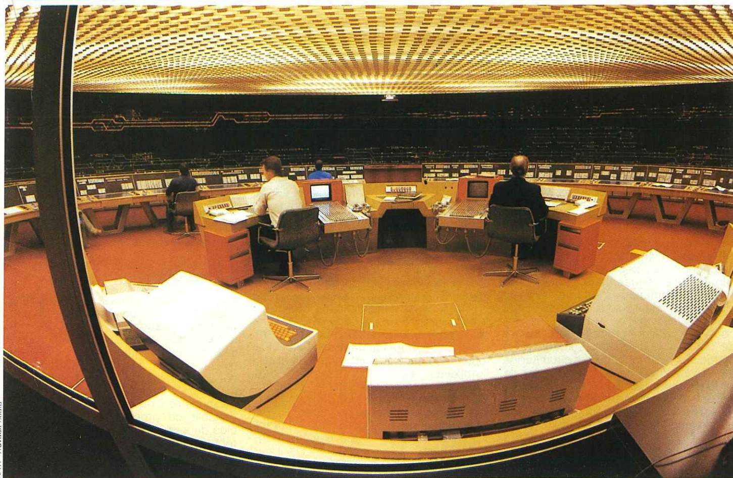
Le poste de commande centralisée de la ligne A du RER à Vincennes.
