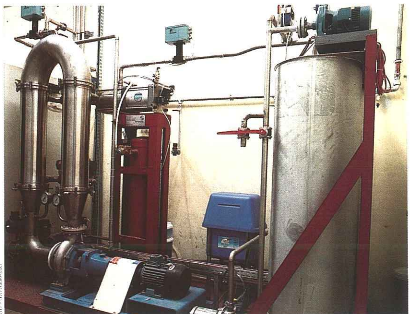
La nouvelle installation de traitement des ERI au centre bus d'Aubervilliers
