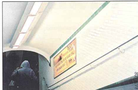
Le nouveau carrelage de la station Anvers.
