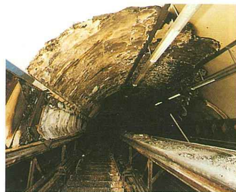
2. Vue des dommages dans la moitié supérieure de la gaine d'escaliers.
