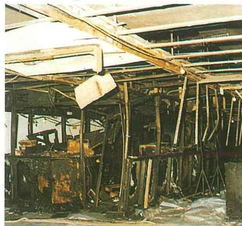
3. La salle de distribution après l'incendie.
