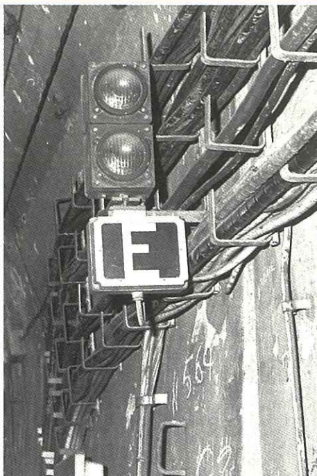
En cas de détériorations sur une nappe de câbles, il est nécessaire de les identifier avant toute intervention : ce type d'incident nécessite le déplacement des responsables concernés.
