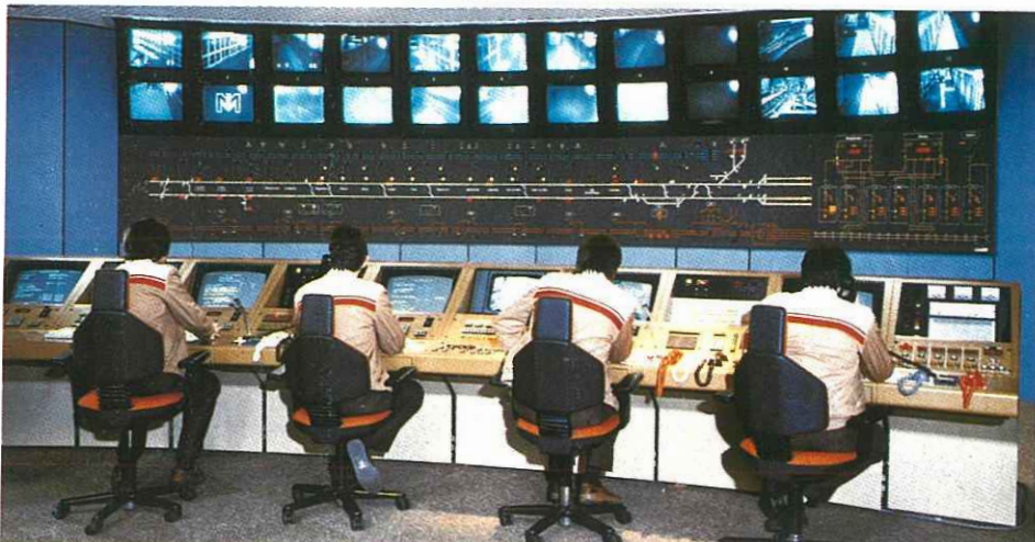
Le poste de conduite central.
