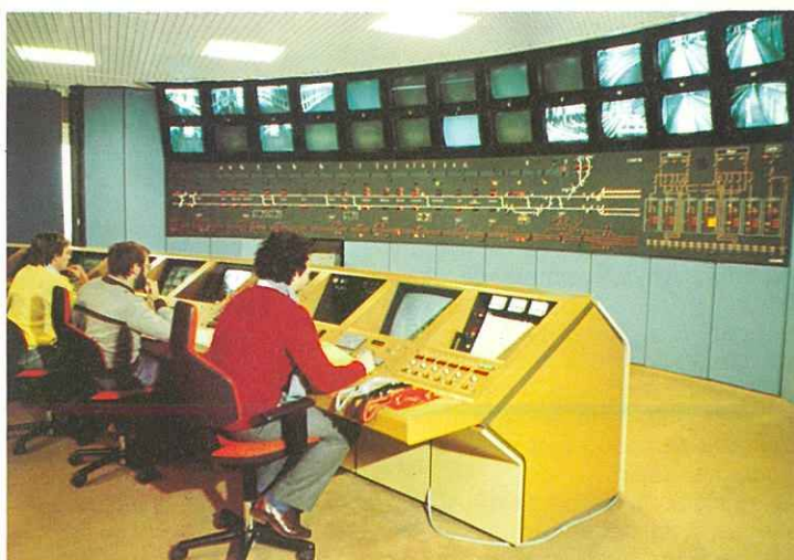
Poste central de contrôle.
