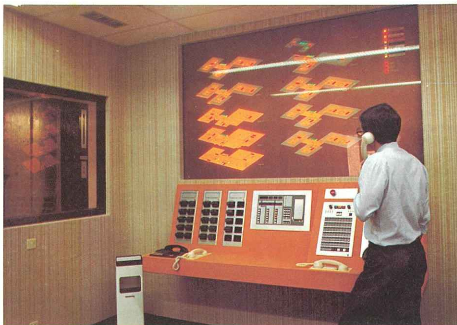
Le poste central de sécurité.
