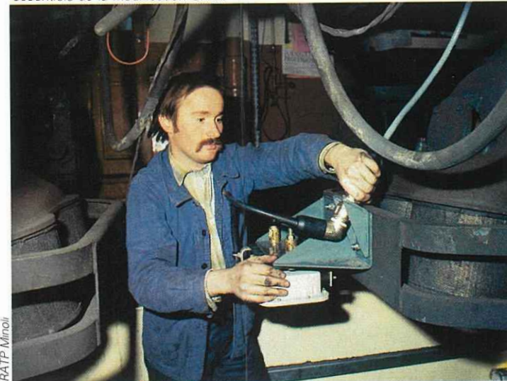
Montage du capteur qui assure la liaison sol-train.
