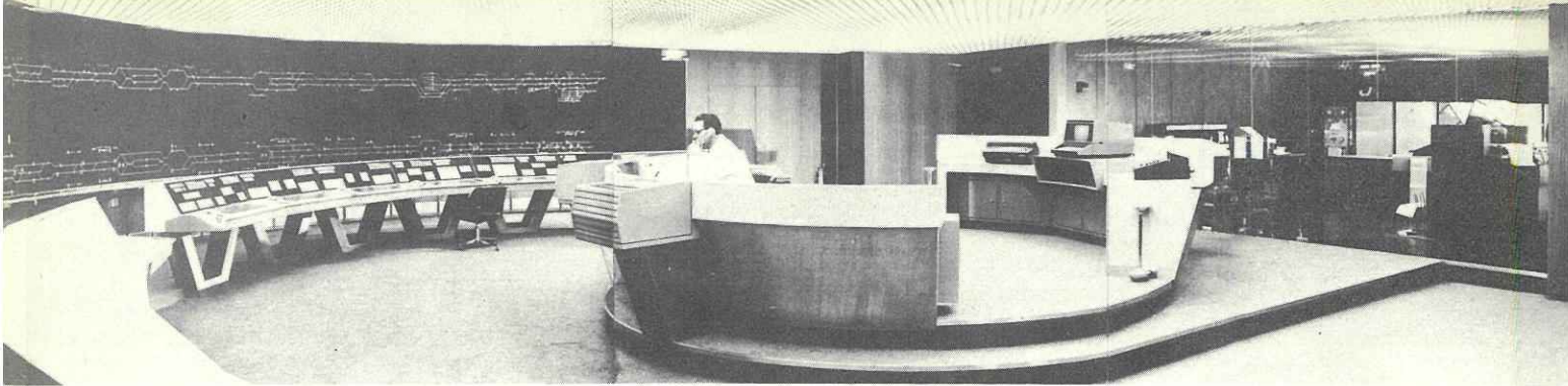
Poste de commande et de contrôle centralisés de l'exploitation (P. C. C.).
