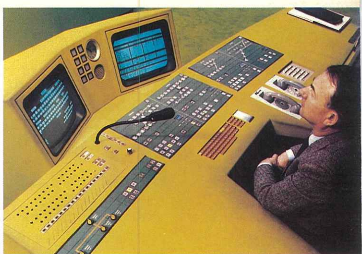
Le PCC (poste de commande et de contrôle centralisés)
