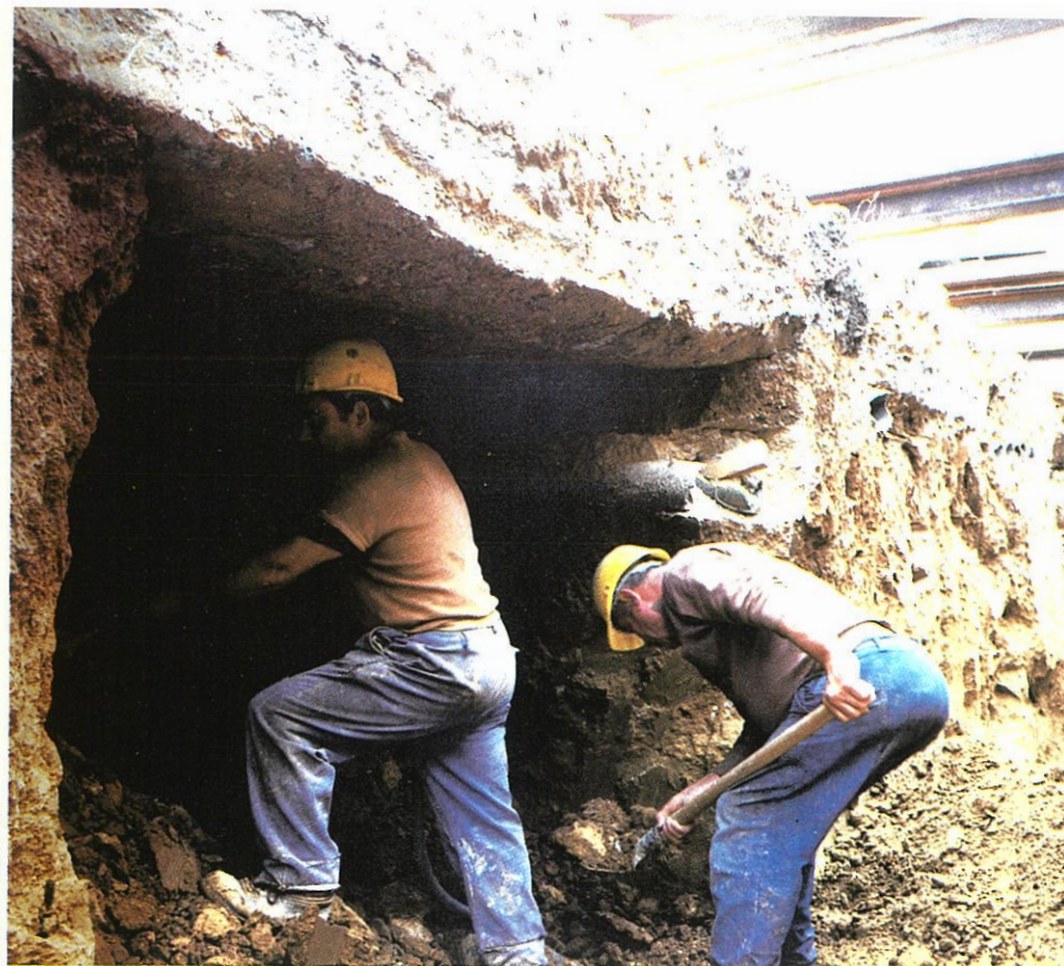
Soutènement de la multitubulaire PTT qui suit le tracé du métro.
