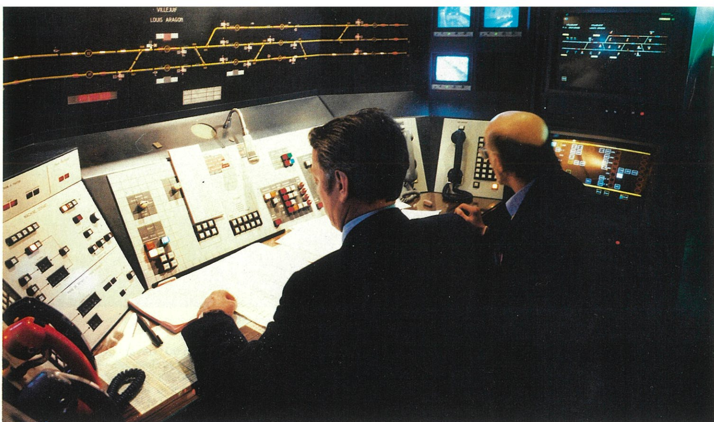
Le poste de manœuvres de Villejuif renferme de nombreuses innovations.
