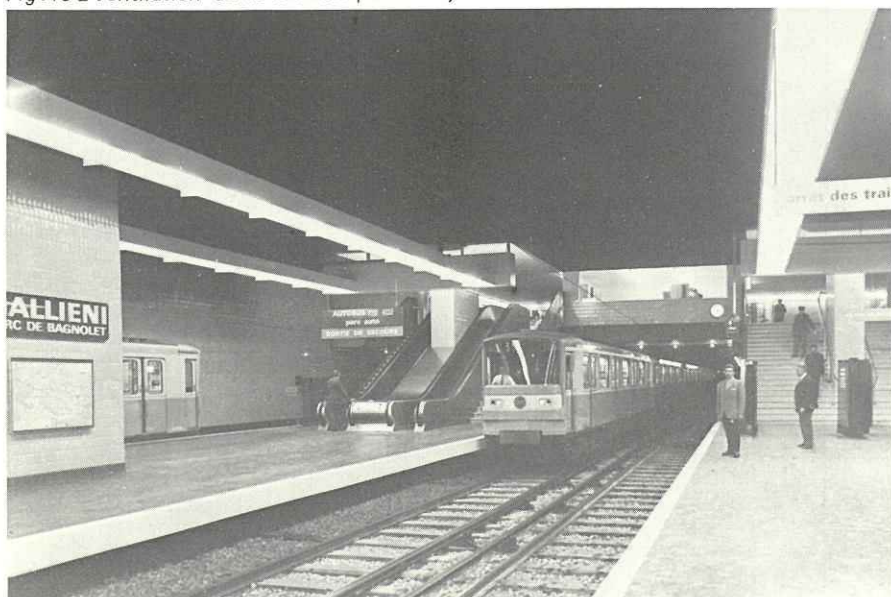
Fig.10_Ventilation de la station (Galliéni)
