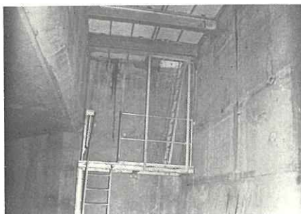
Fig. g - Cheminée de ventilation
